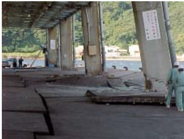
写真2 境港市境漁港 液状化により漁港施設に被害。
