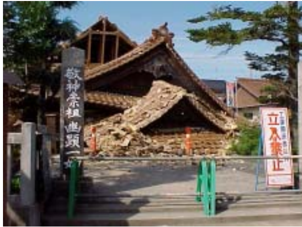
写真1 境港市上道町 出雲大社上道教会の南側半分が倒壊。
