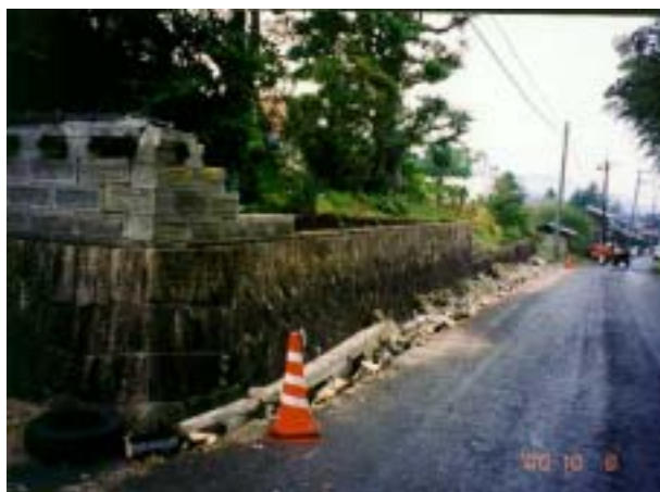
写真 1 3 西伯町西 民家ブロック塀の倒壊。
