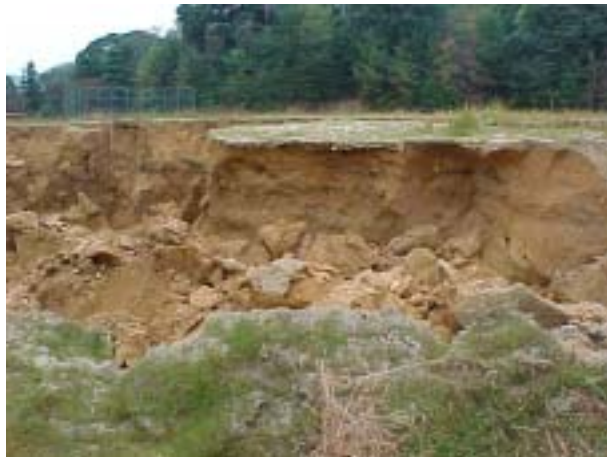
写真 1 2 西伯町法勝寺中学校 法勝寺中学校グラウンドの地割れ。
