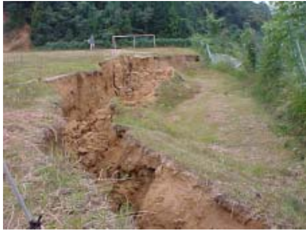
写真 1 1 西伯町法勝寺中学校 法勝寺中学校グラウンドの地割れ。
