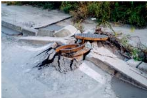
写真6 境港市竹内団地 液状化による地盤の歪みによりマンホールの枠が半分に割れた。
