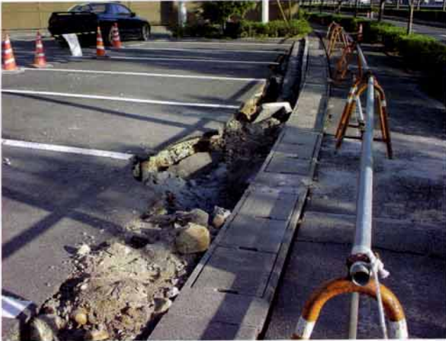
写真-17 団地内駐車場の亀裂と陥没
