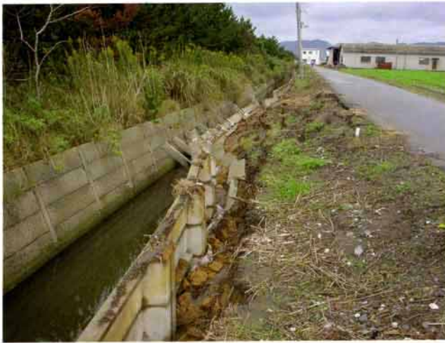
写真-10 排水路よう壁の損壊(E-2)
