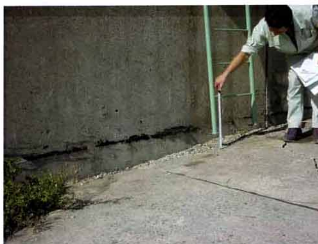
写真-15 護岸部の抜け上がり(G-2)
