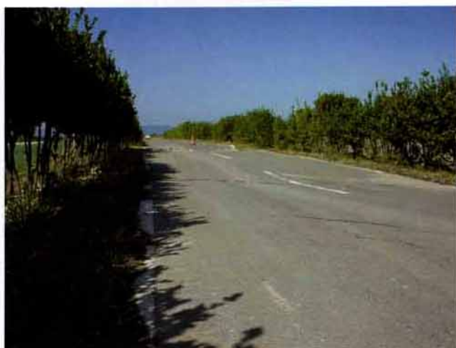
写真-13 道路の陥没と亀裂(F-2)
