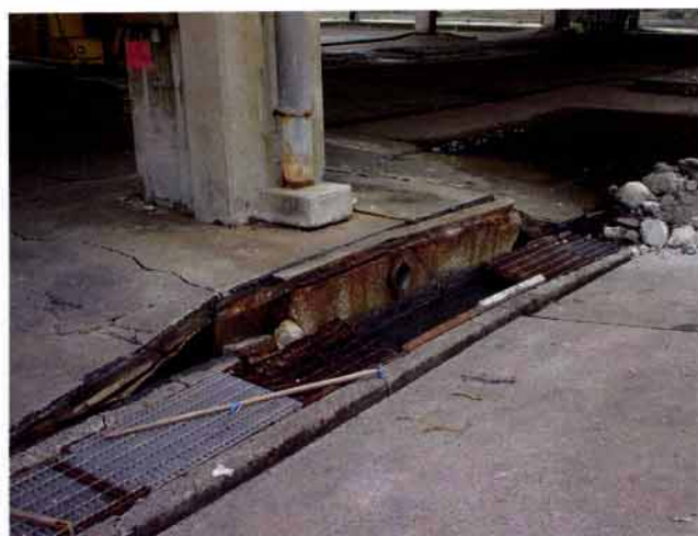
写真-7 抜けあがった上屋の支柱(B-3)
