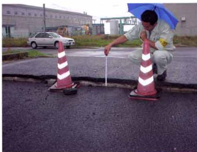
写真－8 暗渠部分の抜け上がり(D-1)
