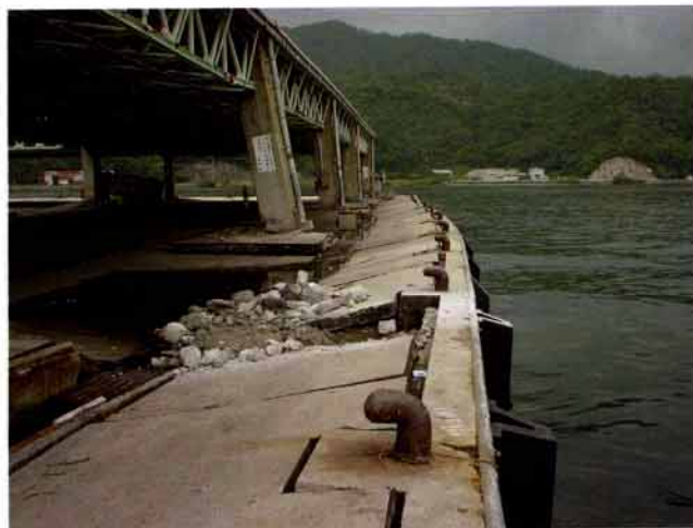
写真-6 カニかご岸壁と倒壊寸前の上屋(B-2)
