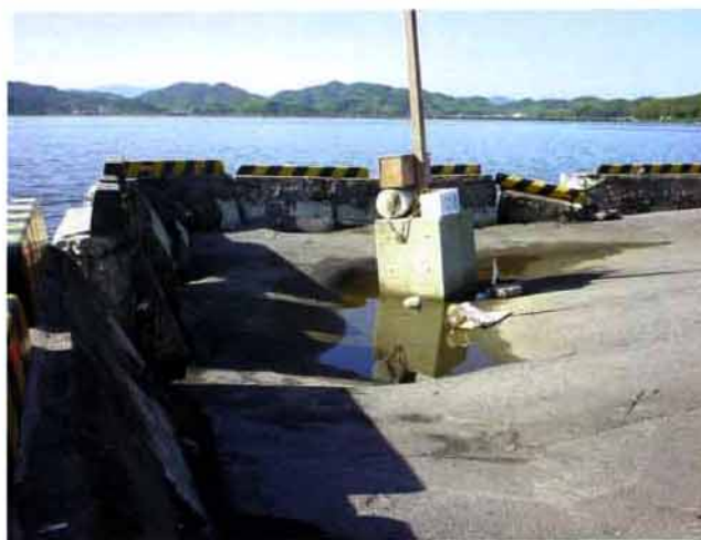
写真-16 米子港岸壁の陥没(G-3)
