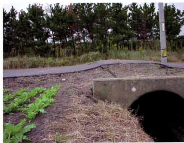
写真－9 管渠部の抜け上がり(E-1)
