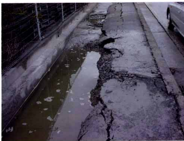
写真-5 道路側溝からの噴砂(B-1)
