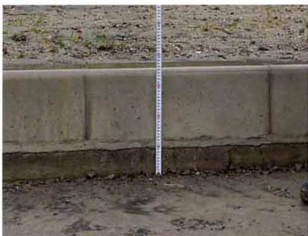
写真-2 道路縁石の抜け上がり(A-2)
