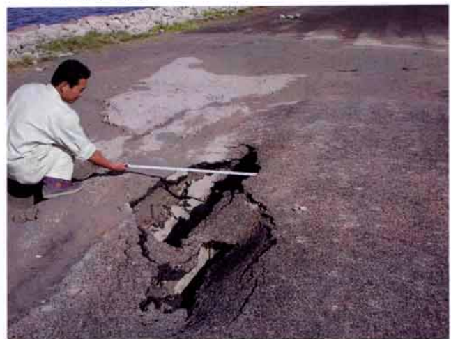
写真-20 堤外地での噴砂と陥没
