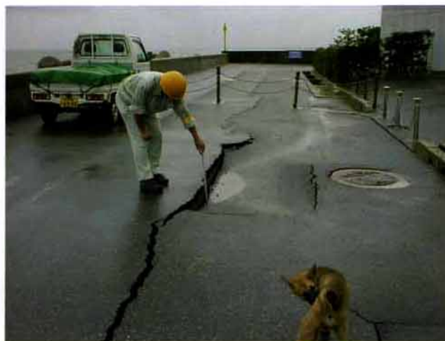
写真-3 外周道路の亀裂と陥没(A-3)
