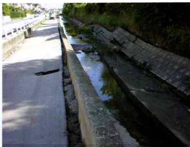
写真-14 排水路よう壁の倒壊と歩道の陥没(G-1)
