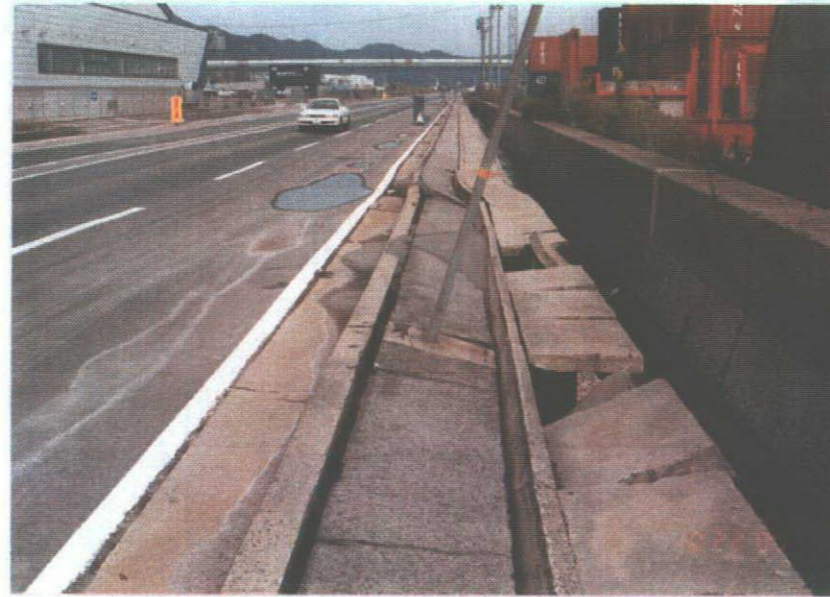
写真一八 県道境外港線南側側溝の変状
