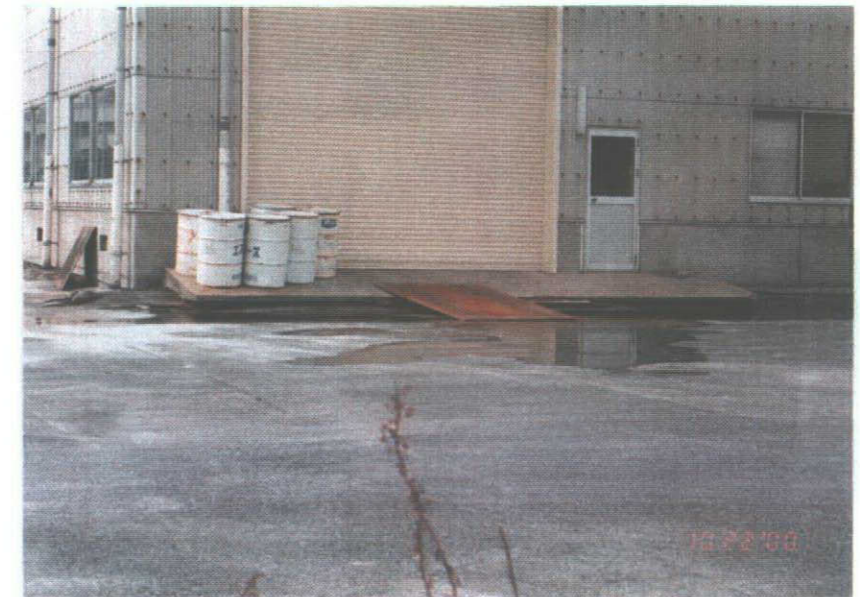
写真一九 山陰化成工業の建物の抜け上がり (周辺地盤の沈下)
