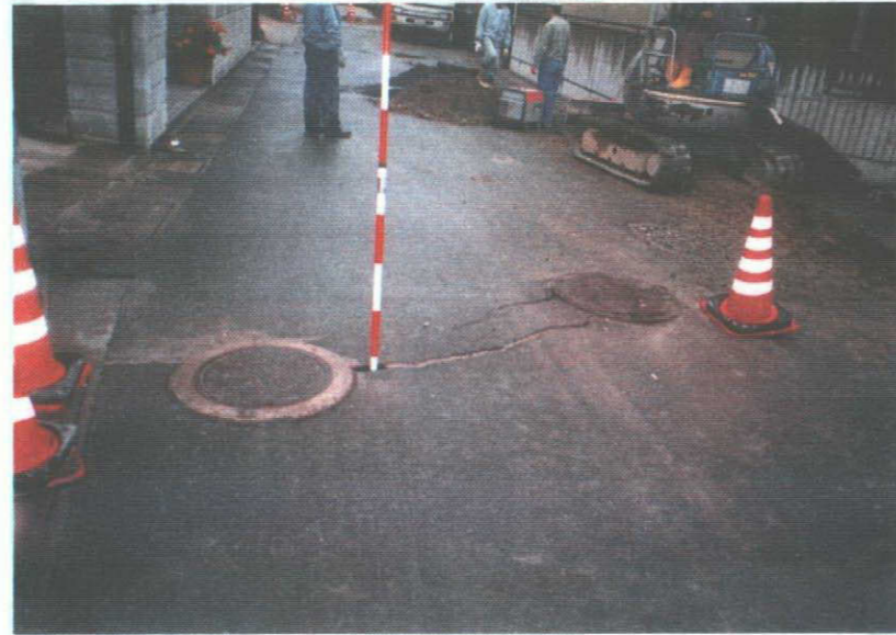
写真-8 マンホール間に発生したクラック。
