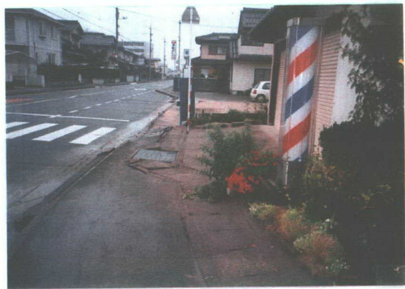
写真-1 歩道にクラック、凹凸及び噴砂の 痕跡が見られる
