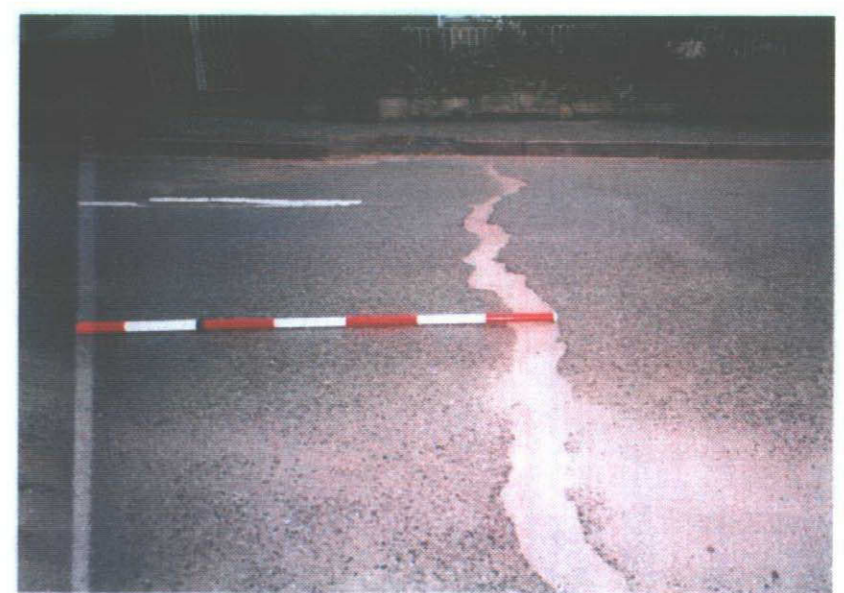
写真-6 道路に発生した開口クラック。
