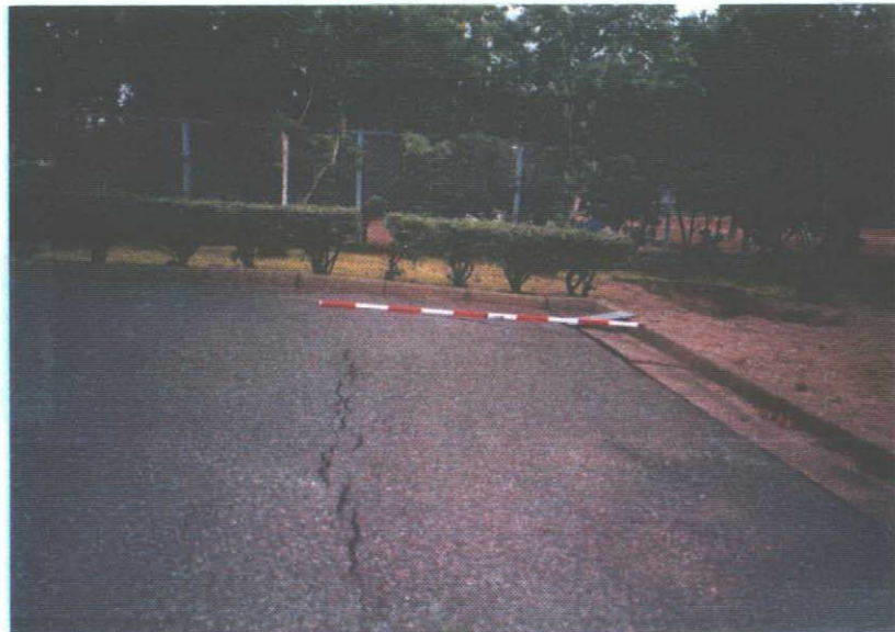
写真-10 駐車場に発生したクラック。
