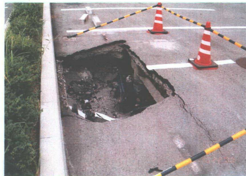
写真一一 境港漁業会館の東側駐車場の陥没
