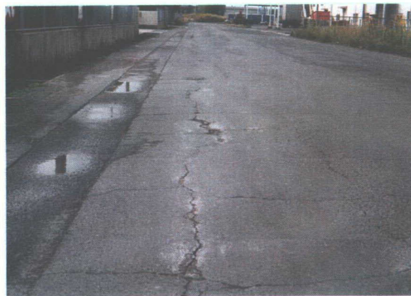
写真-17：道路面のクラック（幅 1cm）と噴砂跡
