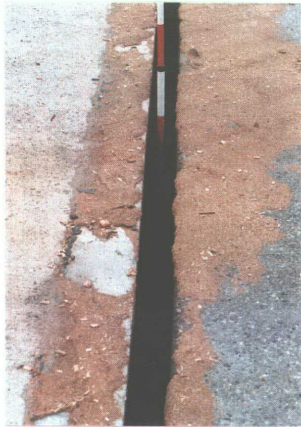
写真一七 外港昭和南埠頭の目地の開き (地盤の沈下)
