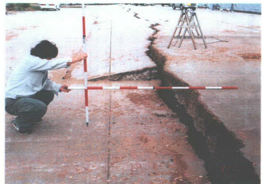
写真一6 外港昭和南埠頭の抜け上がり（北側の沈下）
