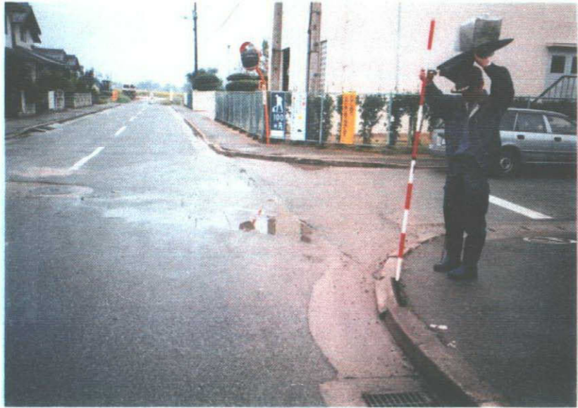
写真-7 交差点に見られる歩道と縁石の変状状況。
