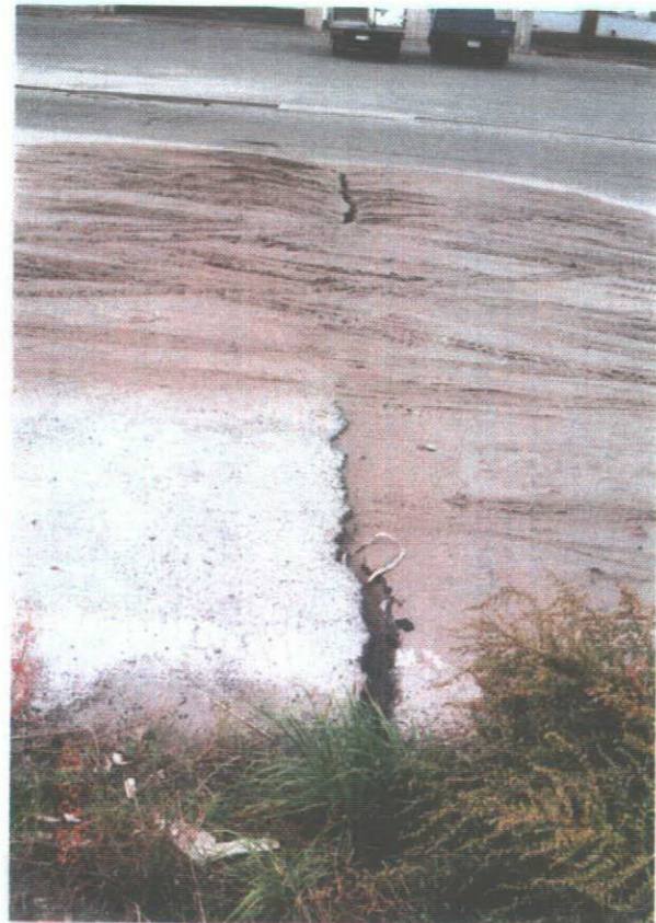
写真一2 鳥取県宮境港水産物地方卸売市場東棟 の南側道路の噴砂とクラック
