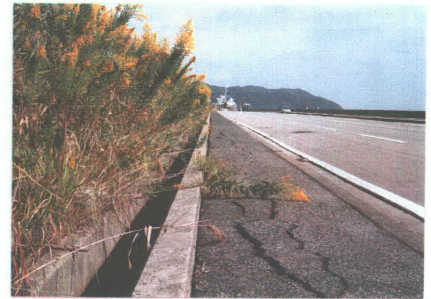
写真-15：道路側溝の押し出し変状と歩道部クラック（5cm）と沈下(10cm)
