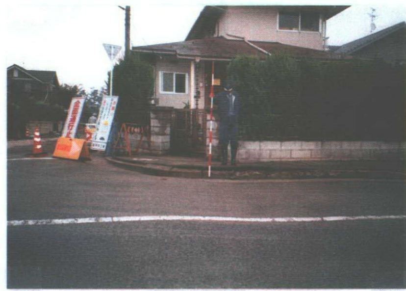
写真-2 縁石の変状。歩道が道路側に移動 隆起している
