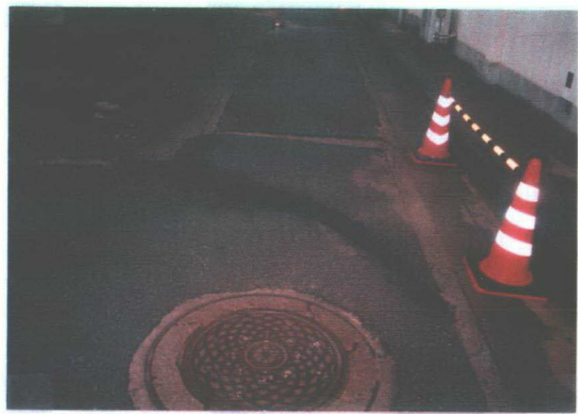
写真-5 段差クラックの発生状況
