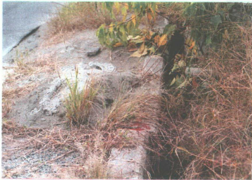
写真一1 新王子製紙チップヤード の南側歩道の噴砂と側溝の変状
