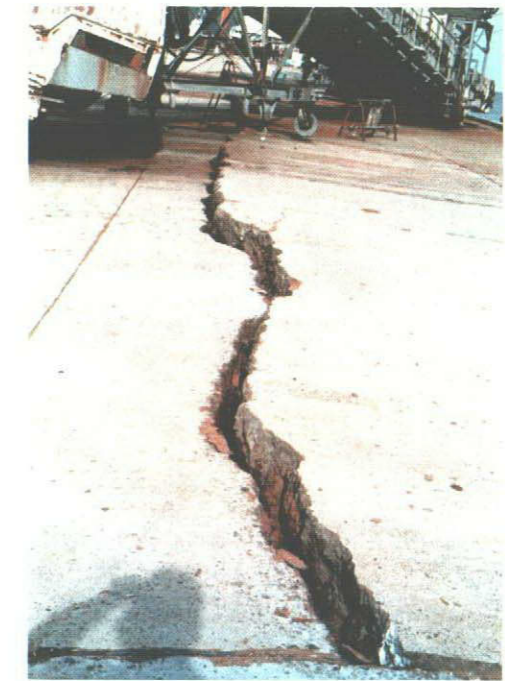
写真-20 ケーソン岸壁背後の亀裂
