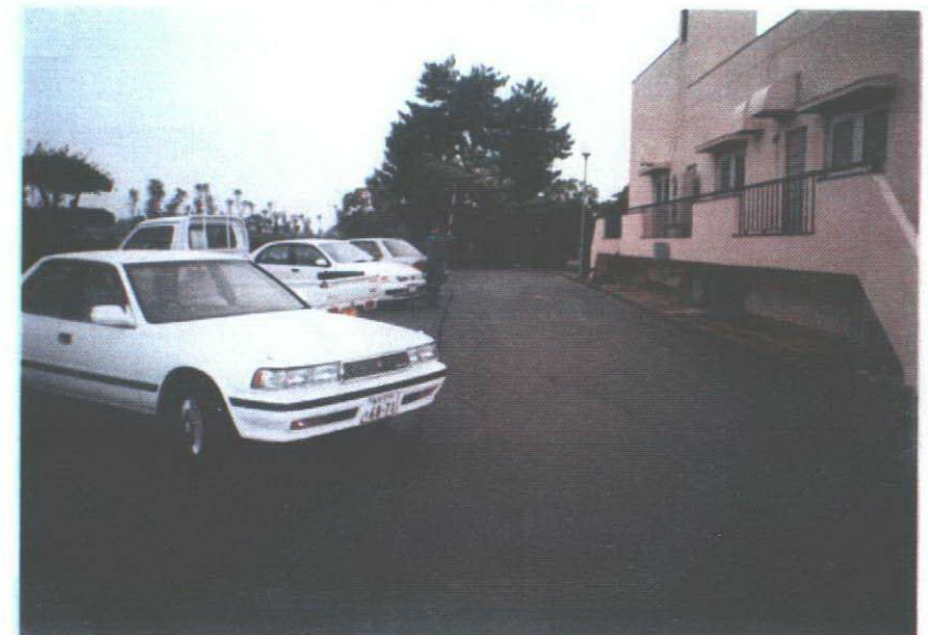
写真-12 駐車場の途中から建物の方へ沈下している。
