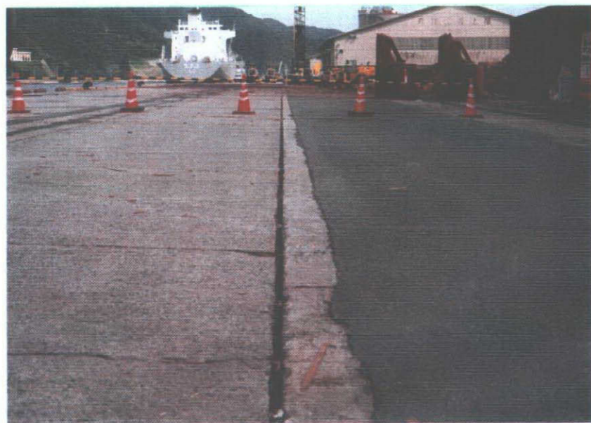
写真-16：岸壁ケーソンの継ぎ目部の開口(5～8cm)
