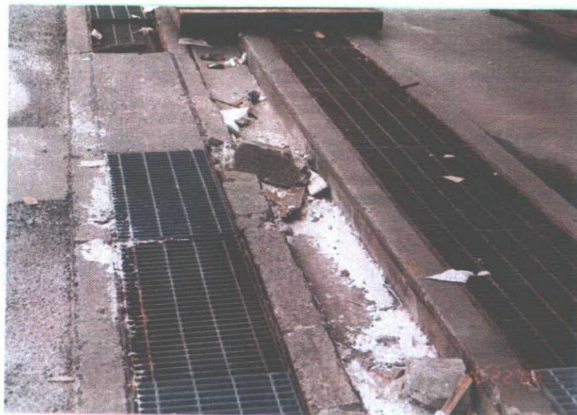
写真一〇 鳥取県営境港水産物地方卸売市場東棟 の抜け上がり (周辺地盤の沈下)
