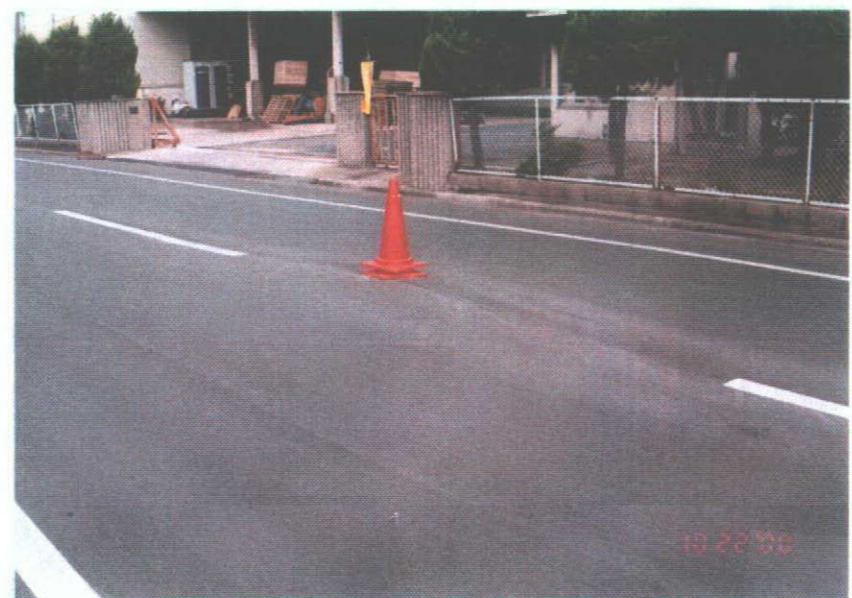
写真一5 境港水産加工業協同組合 の東側道路の浮き上がり
