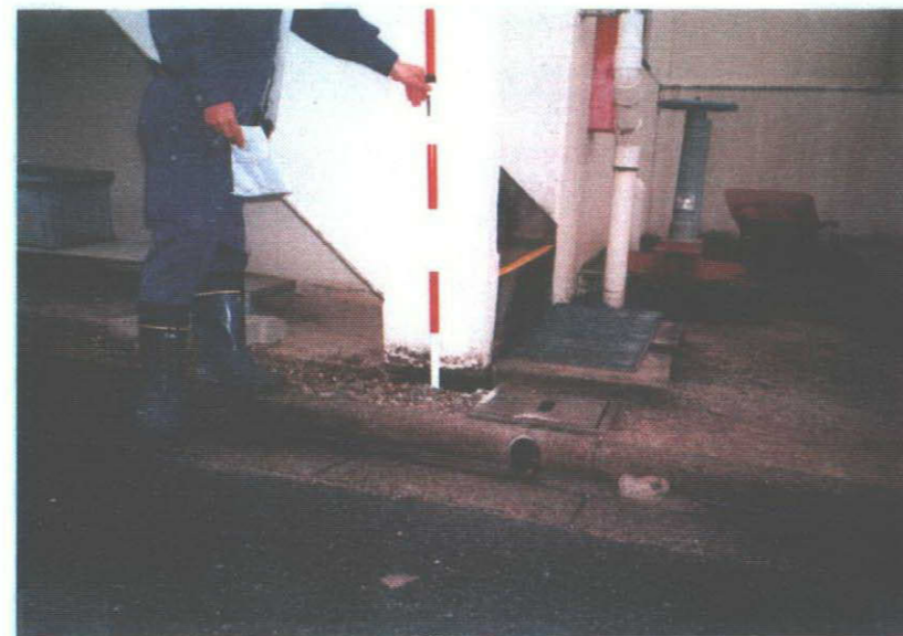
写真-11 建物の抜け上がり。 (杭基礎で周辺地盤が沈下)
