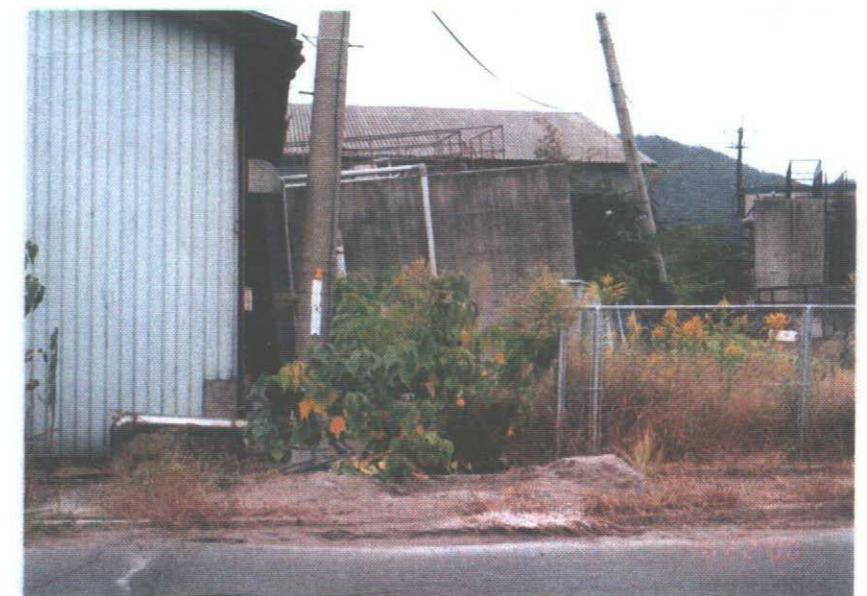
写真一二 島根県漁連境港冷凍冷蔵庫の南西側の水槽の傾き
