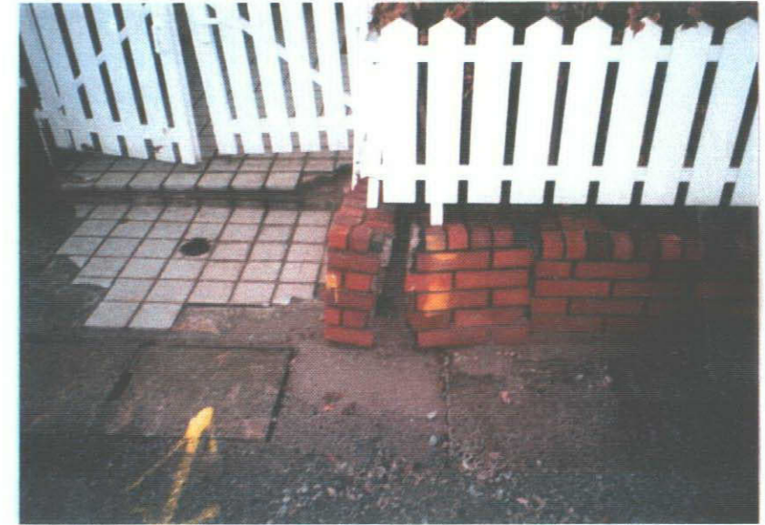
写真-9 民家のレンガブロックの変状。
