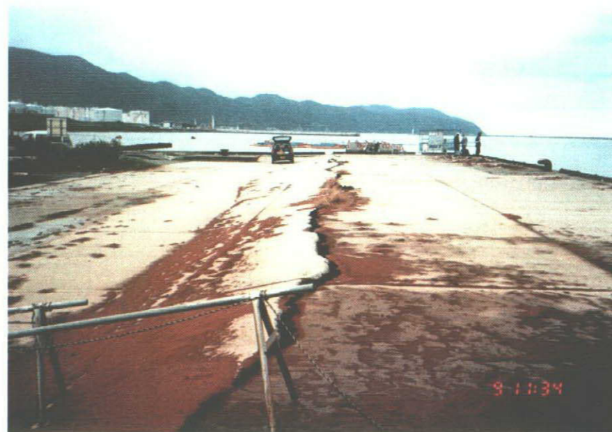
写真-19 ケーソン岸壁背後の亀裂
