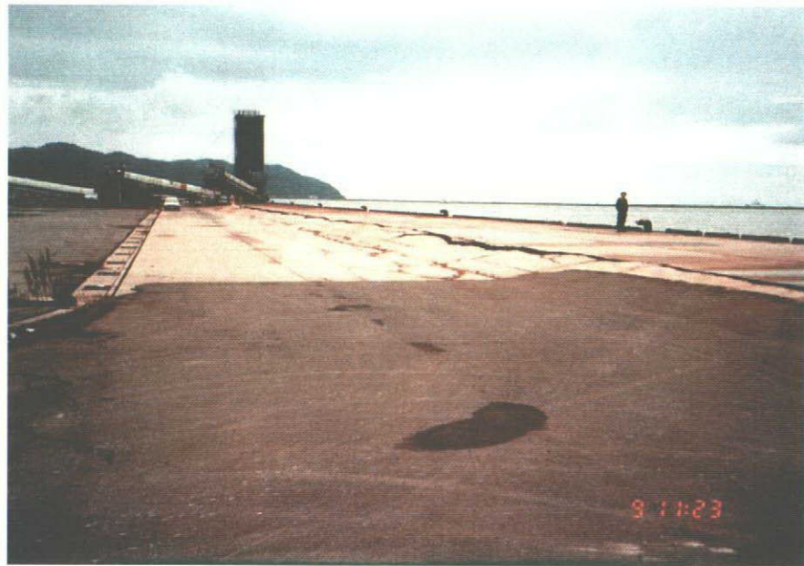
写真-18 ケーソン岸壁背後の亀裂
