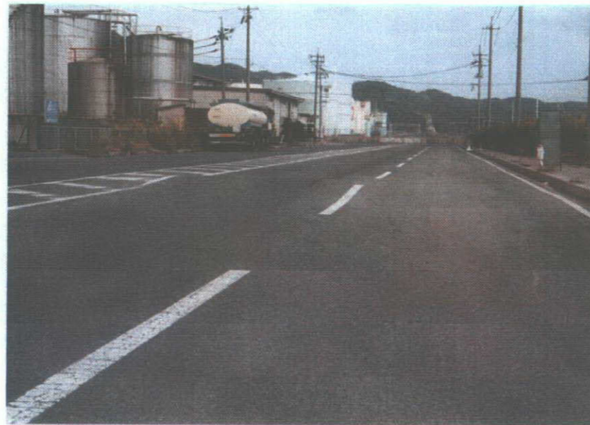
写真-14：アスファルト道路の盛り上がり（最大 20cm）
