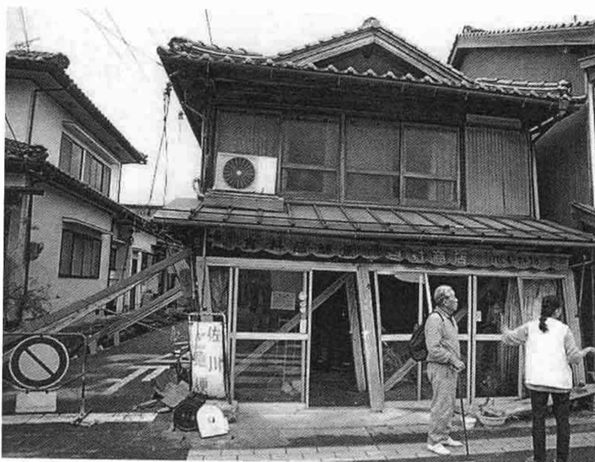
写真1 応急危険度判定で「危険」と判定された建物（日野町黒坂）
