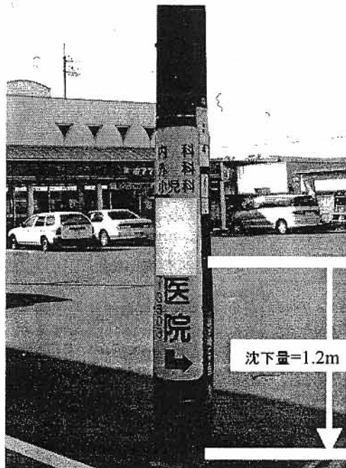
写真-2 配電柱の沈下（米子市旗ヶ崎）
