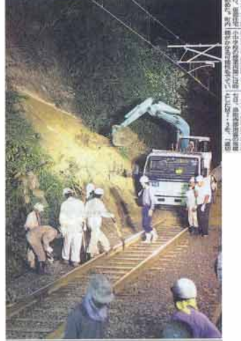
鳥取西部地震の被害状況
