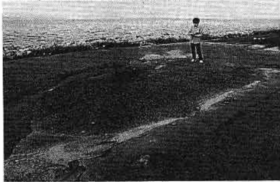
地震による液状化現象で地下から噴き出した泥—東出雲町錦浜の損壊干拓地わきのヘリポートで
