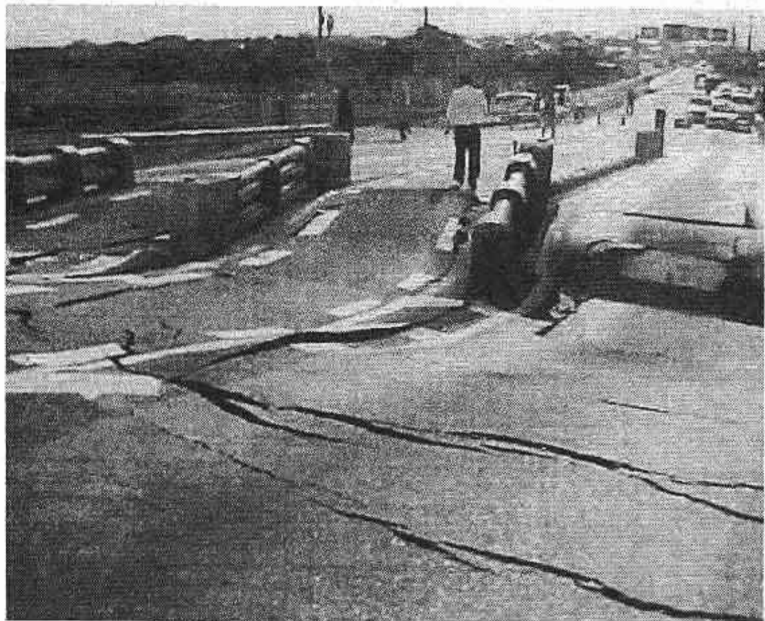
亀裂が入り、陥没した八束町・中浦水門の道路(県消防防災課提供)
