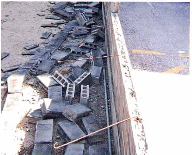
(ブロック塀の被害)
