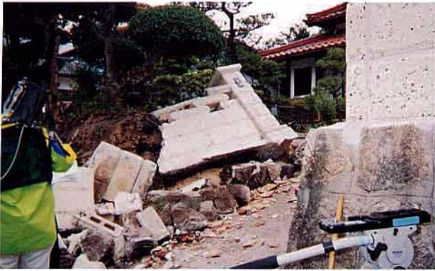
(ブロック塀の被害)
