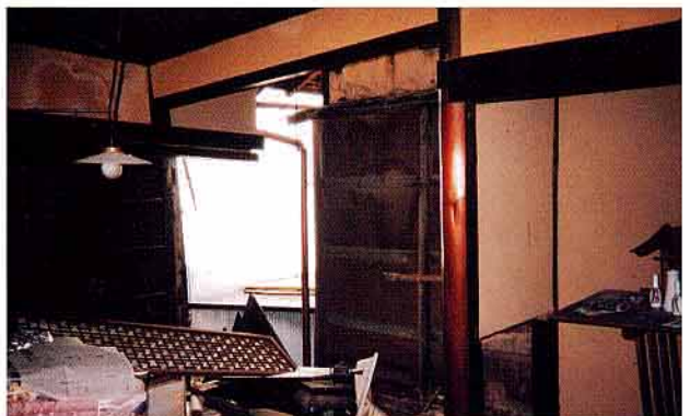
(住宅内部の被害)
