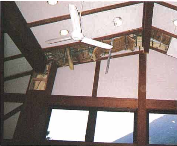
(仕上材の被害)
