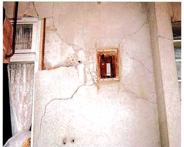
(モルタル壁の被害)
