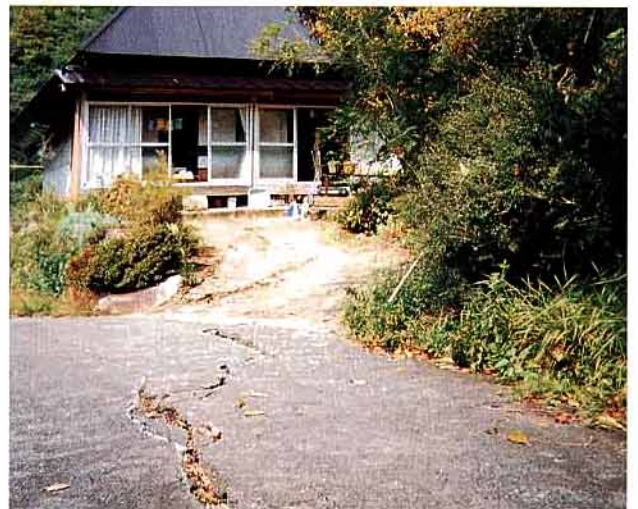
(道路面のひび割)
