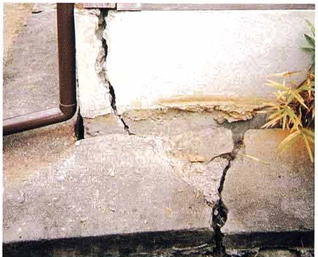
(基礎・犬走の被害)
