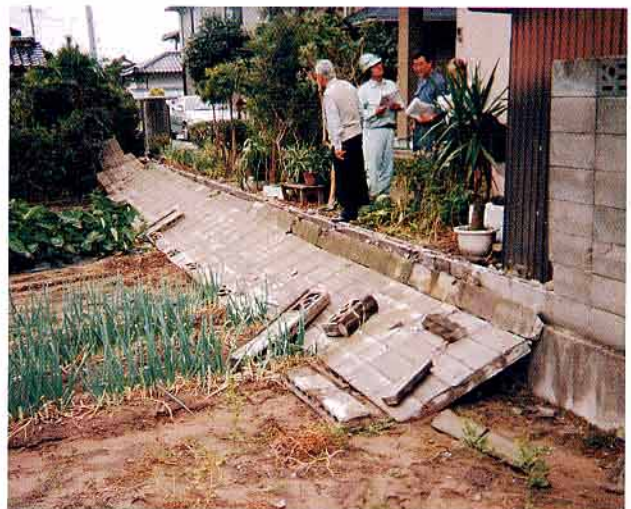
(ブロック塀の被害)
