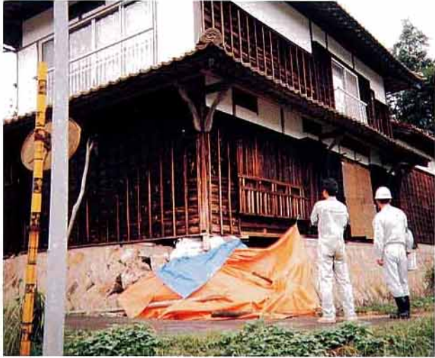
(土台・野づみの被害)
