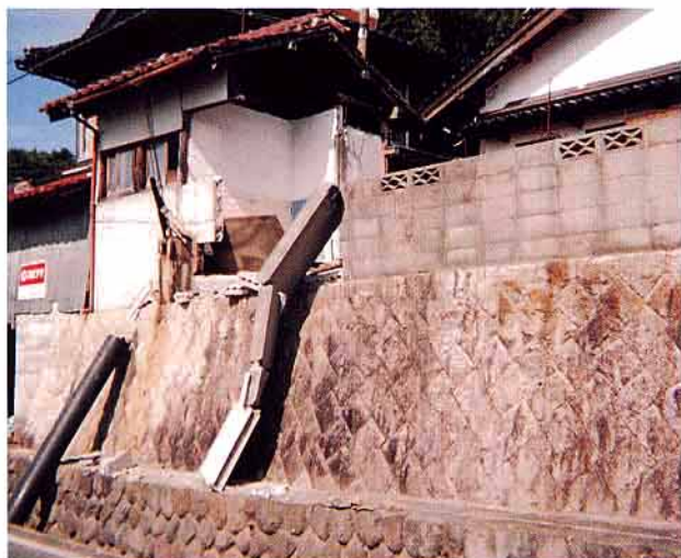
(ブロック壁の被害)
