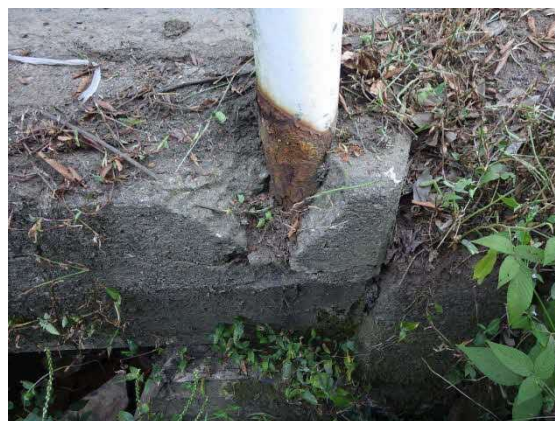
地覆の欠損状況
