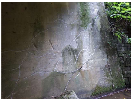
橋台のひびわれ状況
