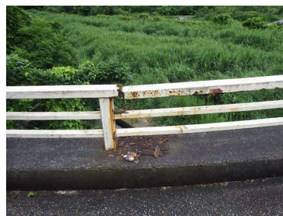
防護柵の破断状況
