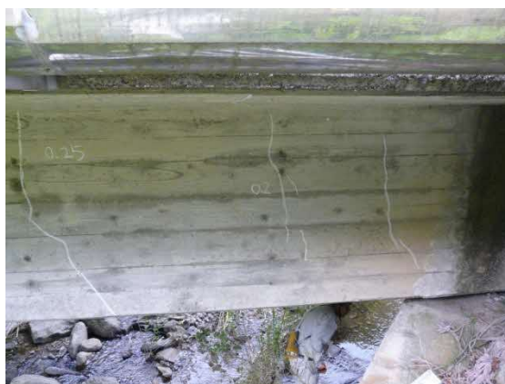
主桁のひびわれ状況
