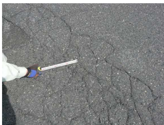
舗装のひびわれ状況
