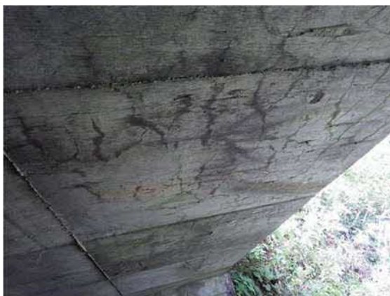
床版下面のひびわれ状況
