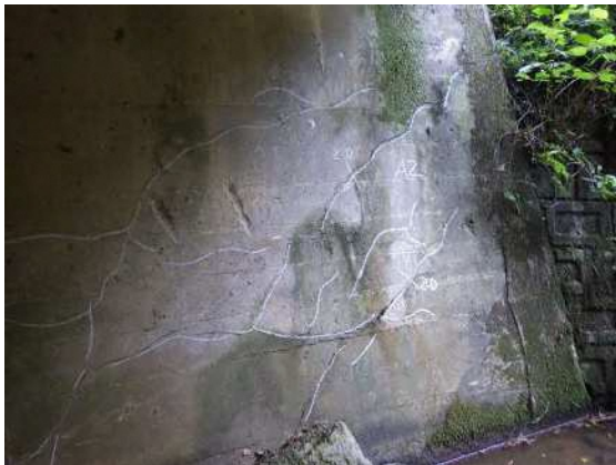
橋台のひびわれ状況
