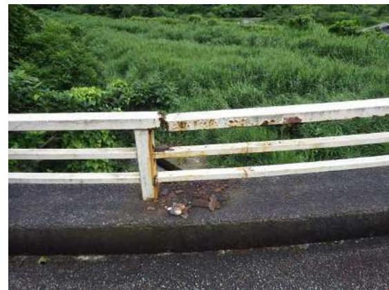
防護柵の破断状況
