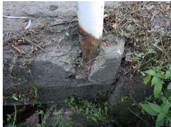
地覆の欠損状況
