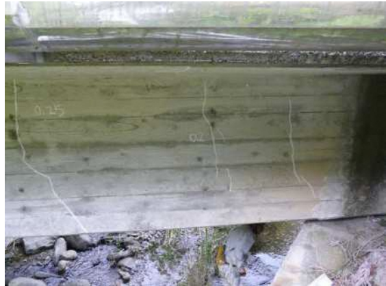
主桁のひびわれ状況
