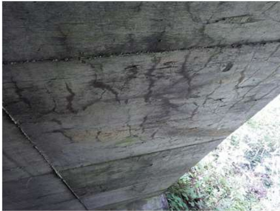
床版下面のひびわれ状況
