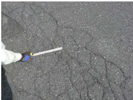
舗装のひびわれ状況
