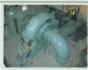
水車・発電機
