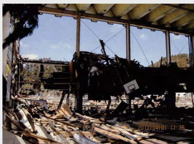
骨組みだけが残った屋内運動場
