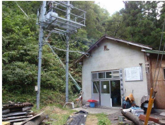
【富沢電化農業協同組合発電所】（智頭町）
