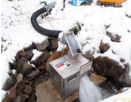
【マイクロ水力発電機（発電機出力2kW）】
