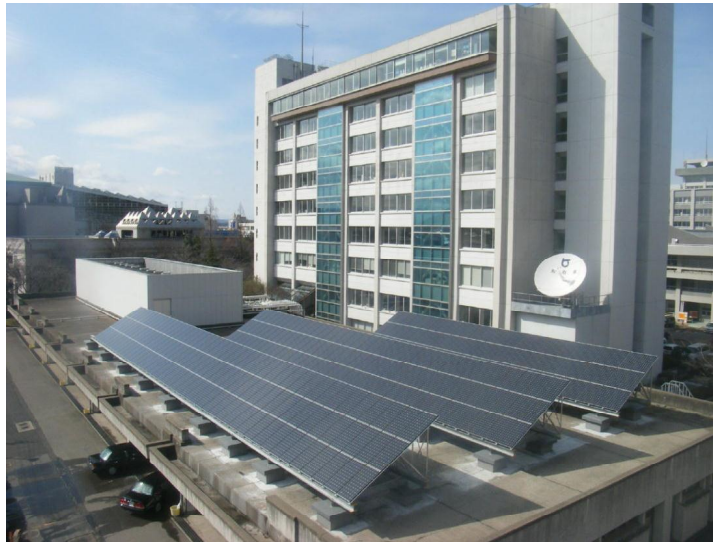
【鳥取県庁太陽光発電システム】
