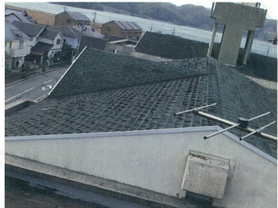
安倍彦名団地(屋根材損傷)
