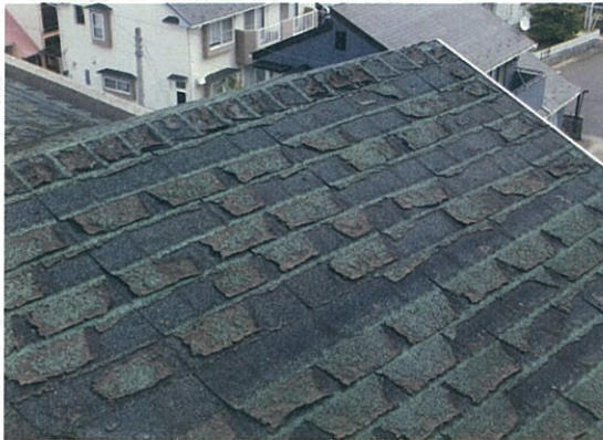
安倍彦名団地(屋根材損傷)
