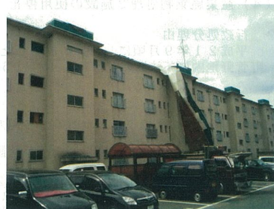
末恒第一団地49-4棟(防水シートの飛散)
