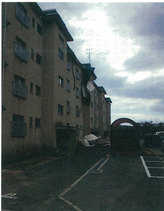
末恒第一団地49-4棟(防水シートの飛散)
