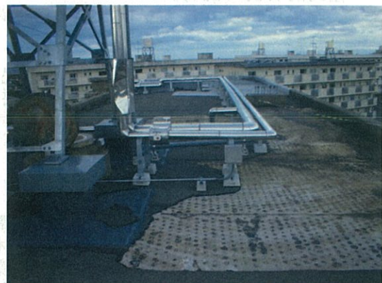
末恒第一団地48-2棟(防水シートの飛散)
