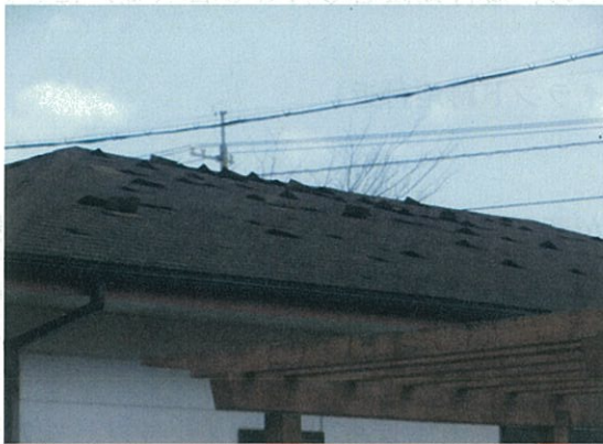
誠道団地(屋根材損傷)
