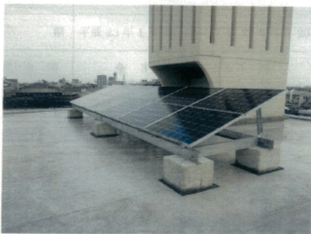
県営住宅の屋上に設置した太陽光パネル
