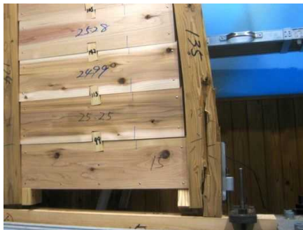
図-2 脆性破壊を起こした柱脚部
