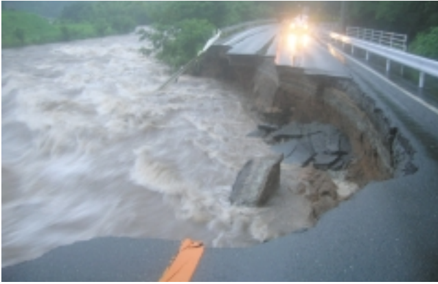
被災直後の状況
