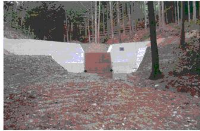
治山ダムの施工により土砂の流出及び溪岸の浸食防止が図られた。
