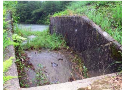
老朽化した洪水吐
