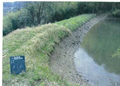
漏水が生じているため池
