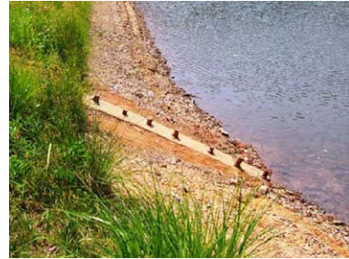
老朽化した取水施設
