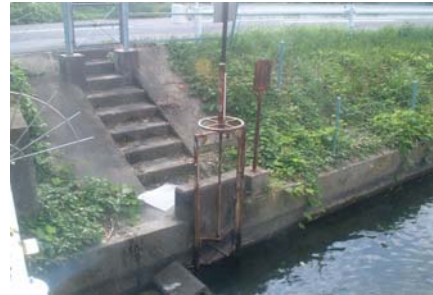
老朽化したゲート
