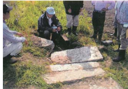
側溝蓋の損傷
