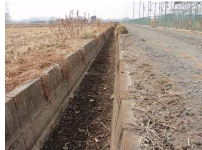
安全施設がない水路
