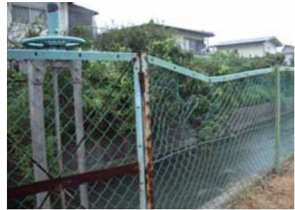
破損した金網フェンス
