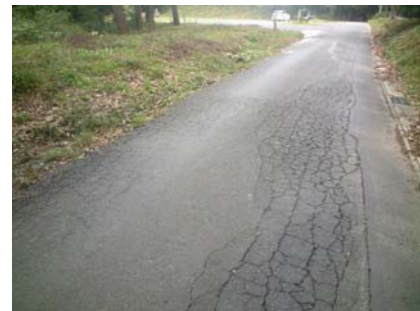
アスファルト舗装の老朽化
