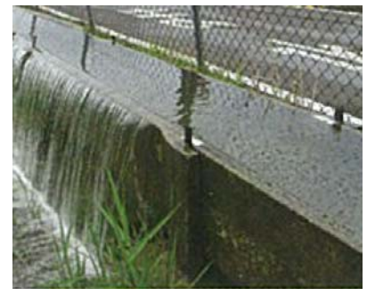
水路からの溢水
