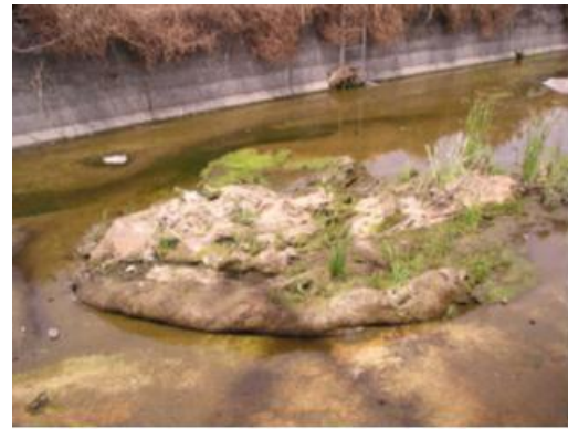
土砂の堆積状況
