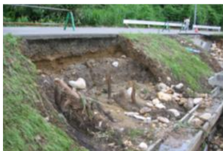
道路法面の崩壊状況
