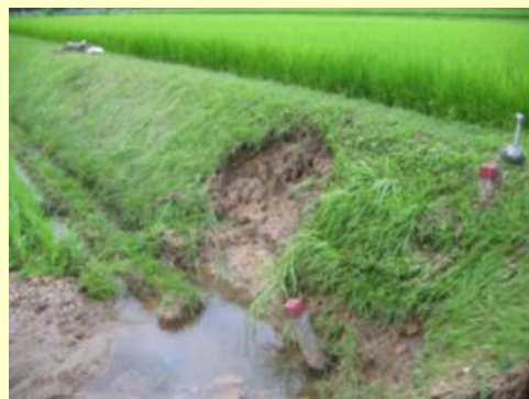
農用地法面が崩れた状況
