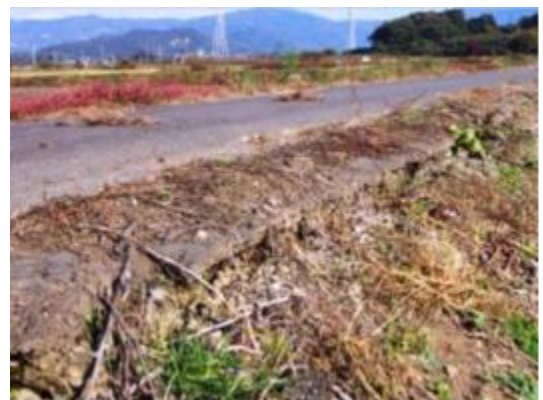
路肩の浸食と路面下の空洞
