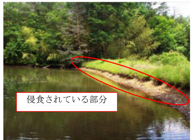
侵食が生じているため池堤体
