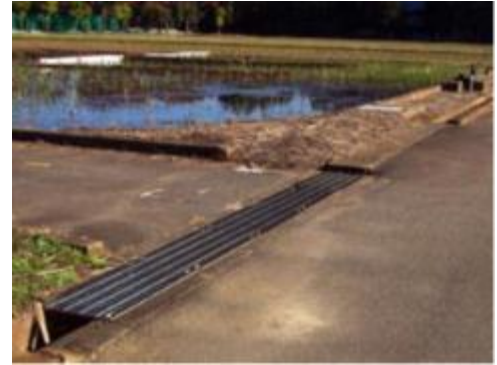
コンクリート蓋とグレーチング
