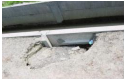
水路側壁の空洞状況
