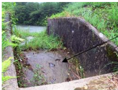
洪水吐底板（コンクリート）の欠損
