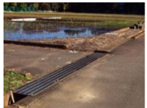
コンクリート蓋とグレーチング
