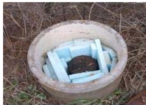
給水栓ボックス内の保温状況
