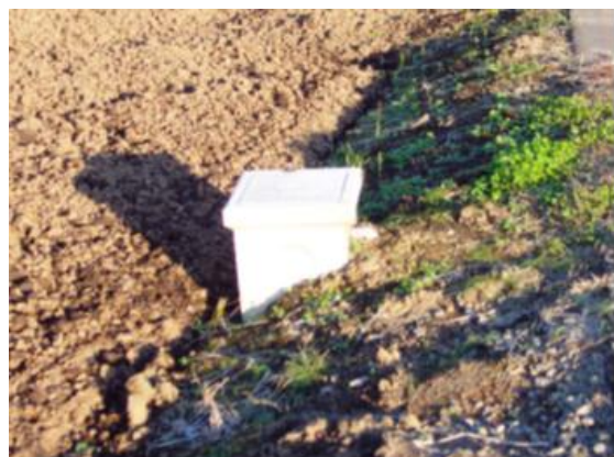
傾いた給水栓ボックス
