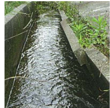
側壁の倒壊（側溝）
