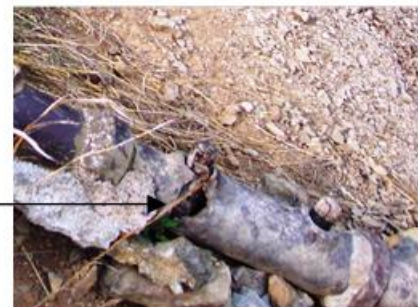
古い樋管（陶製）の破損
