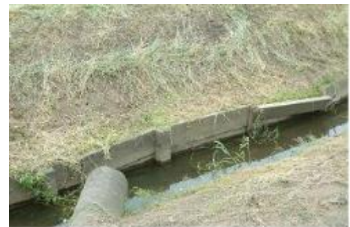
水路側壁のはらみの状況
