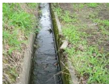
破損したU字溝
