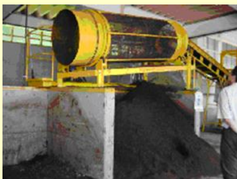
堆肥プラント
