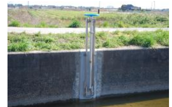
巻き上げ式ゲート（分水用ゲート）
