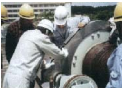
ポンプ点検状況
