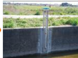
巻き上げ式ゲート
