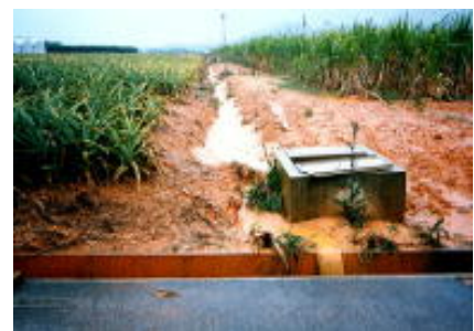
土砂の流出状況
