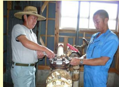
ポンプの点検状況
