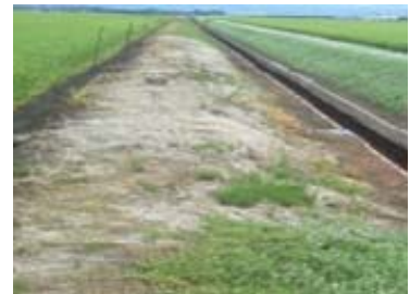
景観悪化の状況
