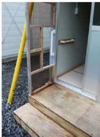
事例1: 玄関内外の手すり
