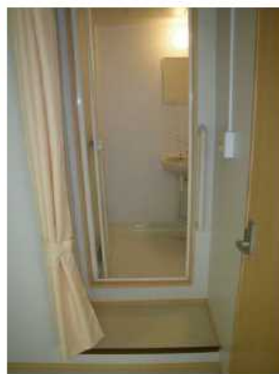
事例4: 浴室前の段差
